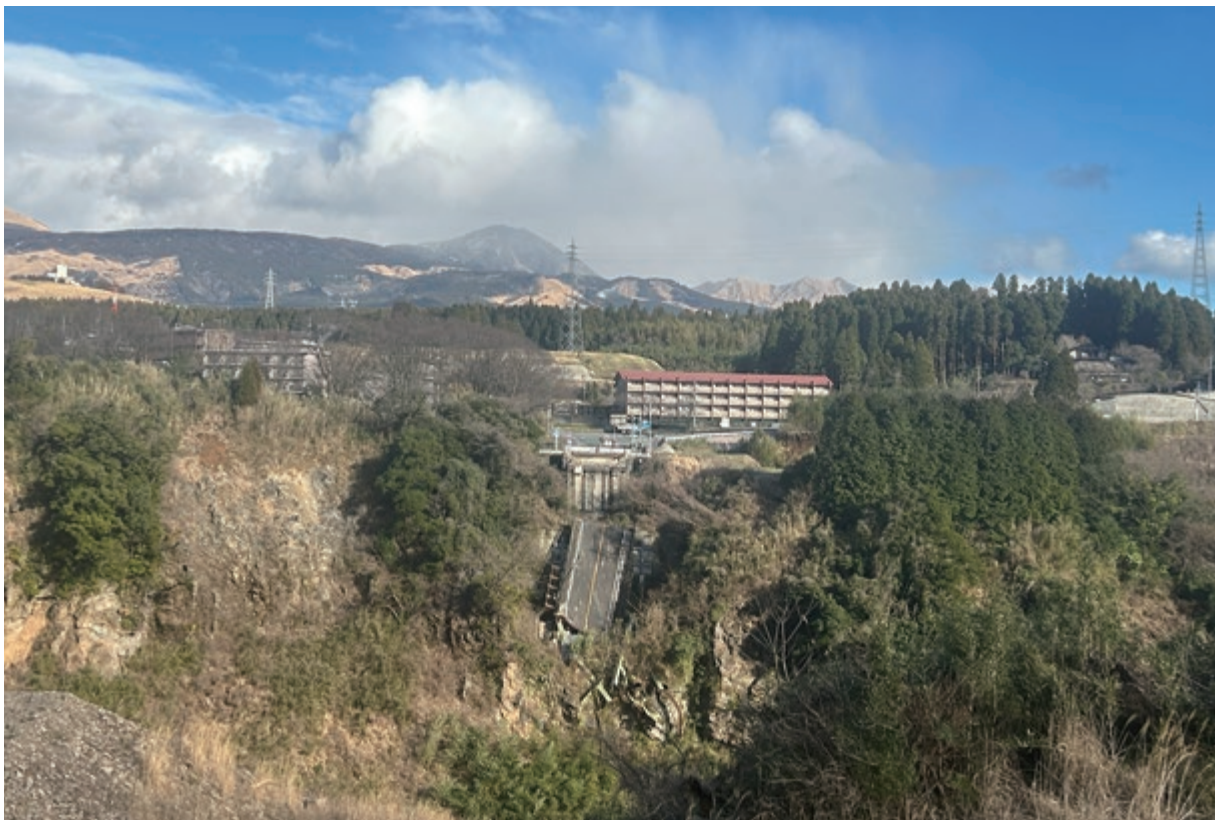
2016年の熊本地震で崩落した阿蘇大橋の一部は今もそのまま
